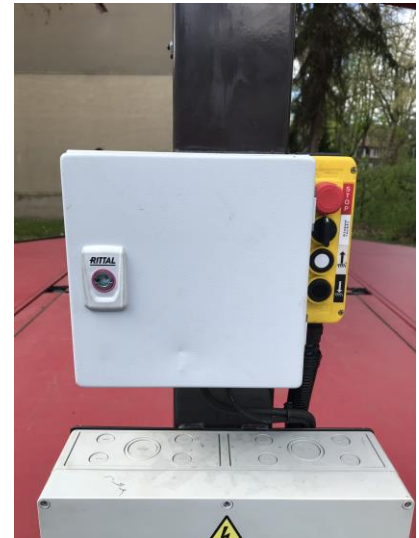
Rittalkiste mit Hydrauliksteuerung
